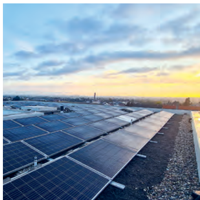
Eine Solaranlage auf dem Dach macht das Gesundheitszentrum autark.
